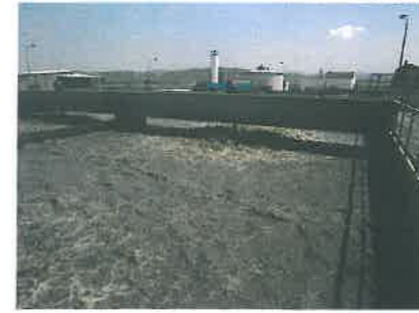
2) Ossidazione biologica a fanghi attivi con aeratore meccanico superficiale
