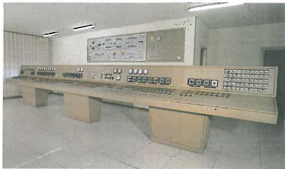
Quadro di comando e controllo generale.
